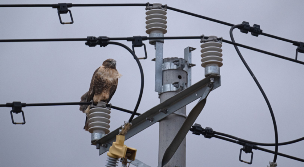
Hochlandbussard auf Hochspannungsleitung. Um Verluste durch Stromschlag zu vermeiden sind die Leitungen von Masten neuerer Bauart voll isoliert.
